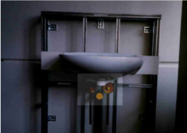
Abb. 5: Installationswand mit Waschtisch, „gelben Stopfen“ sowie Ver- und Entsorgungsleitungen
